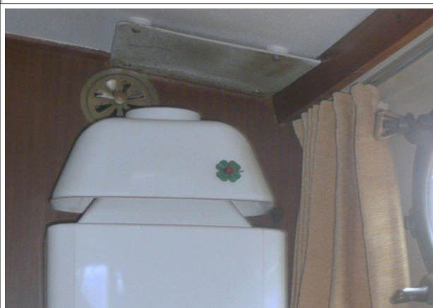
Geiser, afvoer niet naar buiten en gordijnen verhangen.
