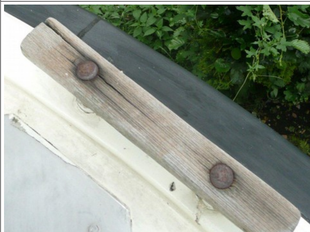
Klamp, gescheurd en gecorrodeerde bouten
