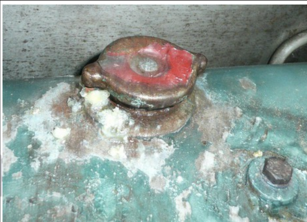
Lekkagespoor aan expansietank.
